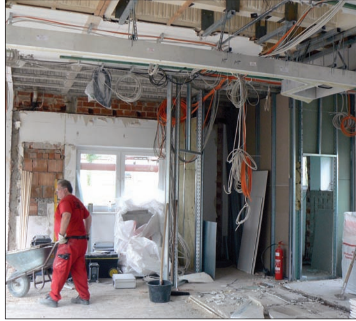
Kabelsalat: Für die neuen Bankräume wurde die Elektrotechnik auf den neuesten Stand gebracht.
